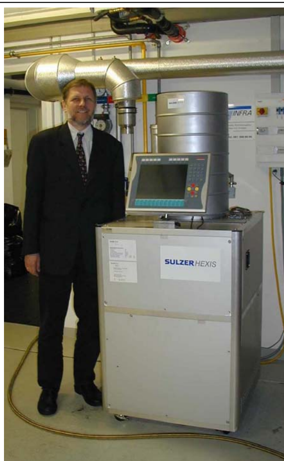
Bild 1: Brennstoffzellen-Heizgerät, P_{el} = 1 \text{ kW} , Sulzer Hexis AG, Projekt Basel
