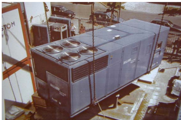
Bild 4: Berlin, 250 kW PEM von Alstom-Ballard
