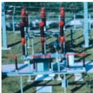
Über die Schaltanlage wird die Energie in das Netz abgeleitet.
