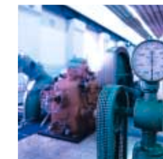
Detailansicht der Produktionsanlage.
