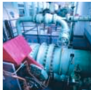
Turbinenabsperrarmaturen im Maschinenhaus.
