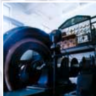
Generator 3 (Baujahr 1925) mit Hauptschalttafel im Hintergrund (Baujahr 1908)
